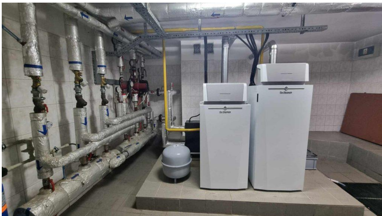
Zdjęcie nr 6. Zmodernizowana kotłownia w Szkole Podstawowej im. Kardynała Stefana Wyszyńskiego w Siedliskach
