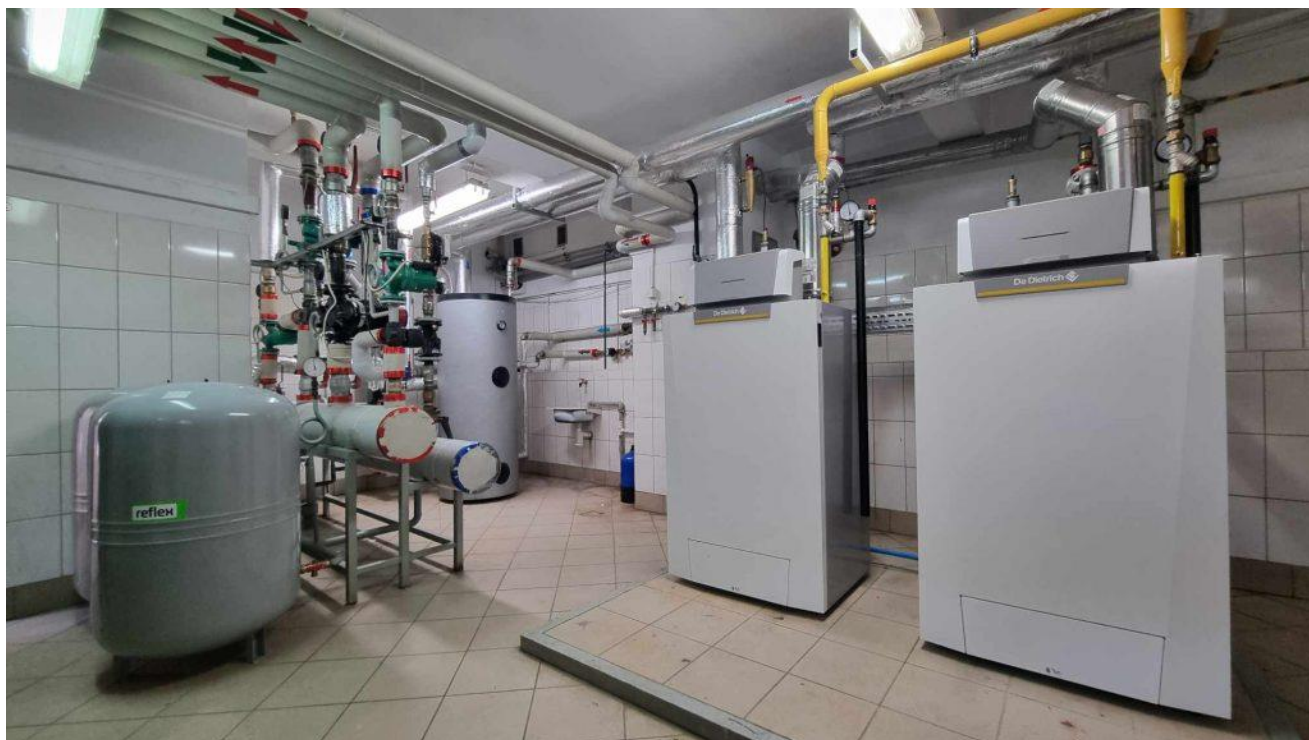
Zdjęcie nr 5. Zmodernizowana kotłownia w Szkole Podstawowej im. Stanisława Staszica w Tuchowie
